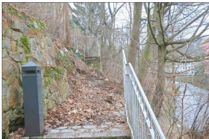
Die marode Steganlage wurde bereits entfernt
